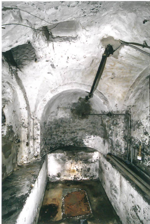
Abb. 4: Münsingen, Kirche. Die romanische Krypta im Untergeschoss des südlichen Annexes unter dem gotischen Turm. Blick nach Osten.
