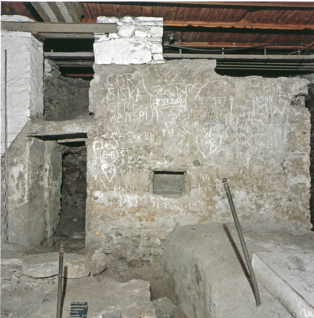
Abb. 4: Nordwand des Rechteckchores im Vorzustand, übersät mit Besucherinschriften und stark verschmutzt.
