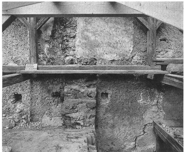
Abb. 4: Der mittlere der drei abgebrochenen Stützpfiler.
