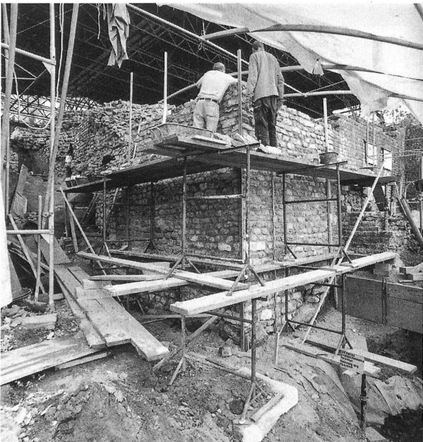
Abb. 115: Studen - Grabefeld / Petinesca 1993–96. Mauersanierungen 1994. Die ursprüngliche Mauerschale der südöstlichen Aussenmauer ist – im Gegensatz zum Kern – nur noch auf wenigen Quadratmetern im Bereich der Südecke erhalten. Die Maurer festigen und ergänzen die Südecke der mächtigen spätrömischen Anlage mit Jurakalksteinen. Blickrichtung Westen.
