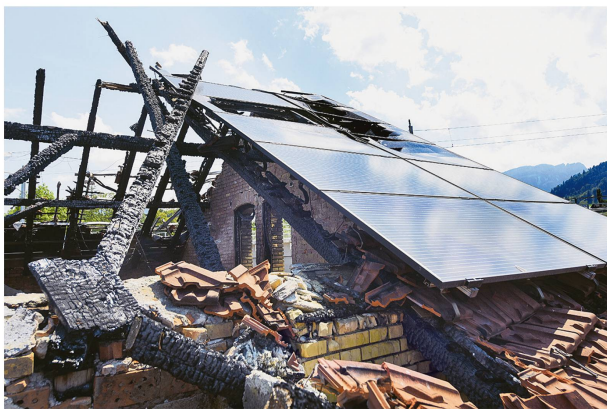
Beim Grossbrand im Produktionsbetrieb der Bäckerei Böhli an der Weissbadstrasse in Appenzell entstand Totalschaden. Das Gebäude wird abgebrochen.
