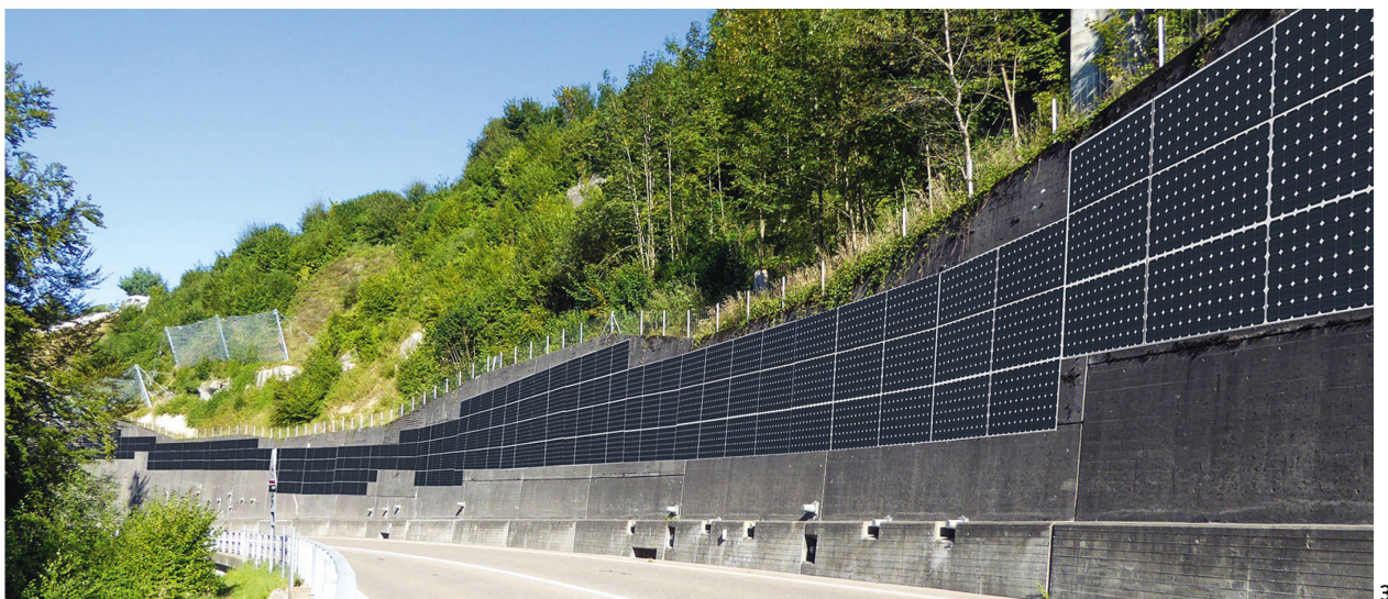
Die Photovoltaikanlage an der Mauer der Umfahrung Teufen gilt als energiepolitisches Leuchtturmprojekt.
