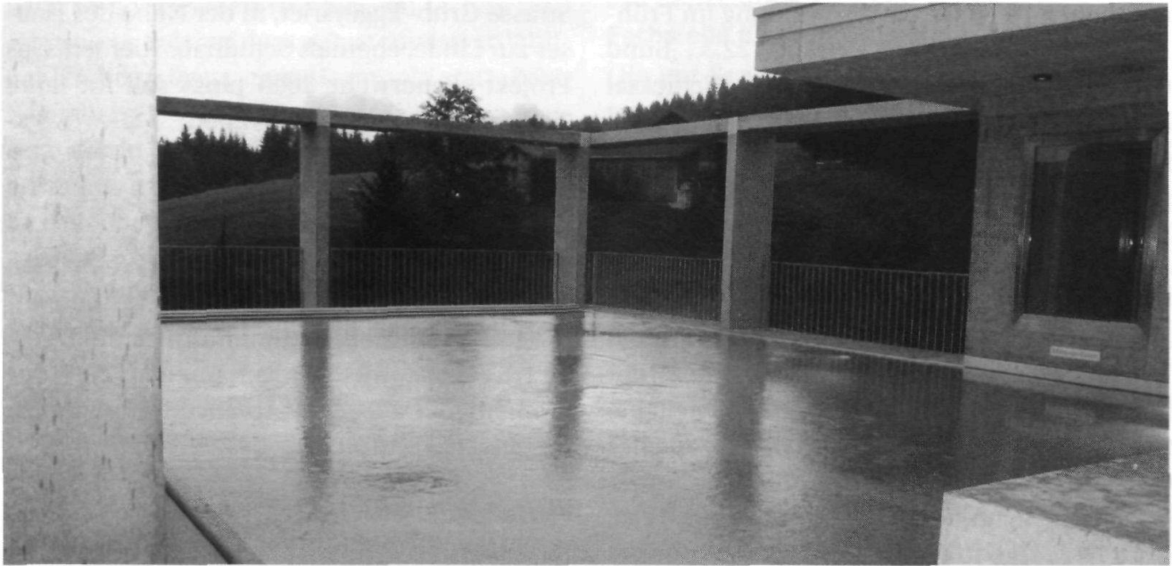
Die erste Etappe zum Vorderländer Gesundheits- und Wellnesspark ist erfolgreich beendet. Das Heilbad Unterrechtestein verfügt neu über ein beheiztes Aussenbad. (Bild: Isabelle Kürsteiner)
