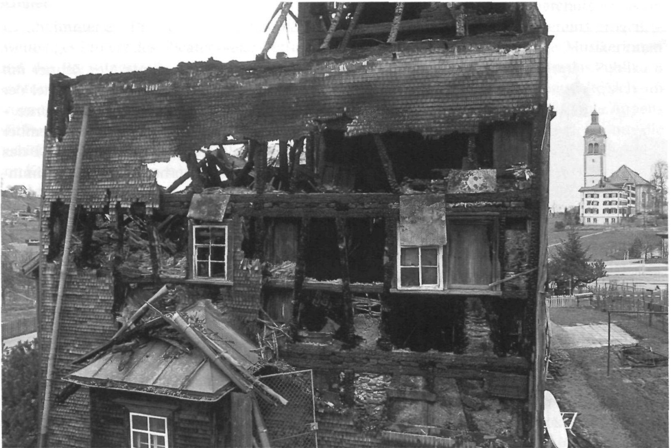
Ende März zerstörte ein Brand ein Wohnhaus mitten im Dorf.
