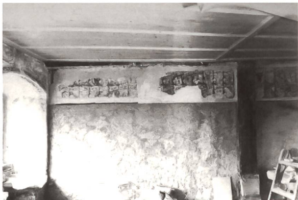
Die «grosse Stube» während der Restaurierungsarbeiten 1959/60: Der heutige Wappenfries ist vor allem das Produkt der Erneuerung von 1960, als das Museumsschloss eingerichtet wurde. (Denkmalpflege des Kantons Thurgau, aus: Meile 2005).
