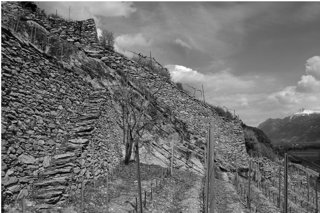
Murs en pierres sèches du parchet de Clavoz entre Sion et Uvrier.
