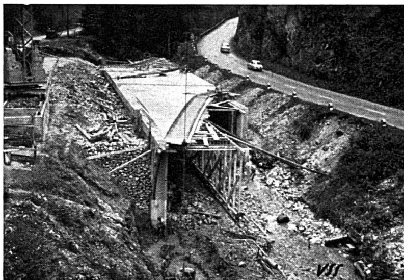
Fig. 6. Le pont amont en construction, après le bétonnage de la dalle biaise
