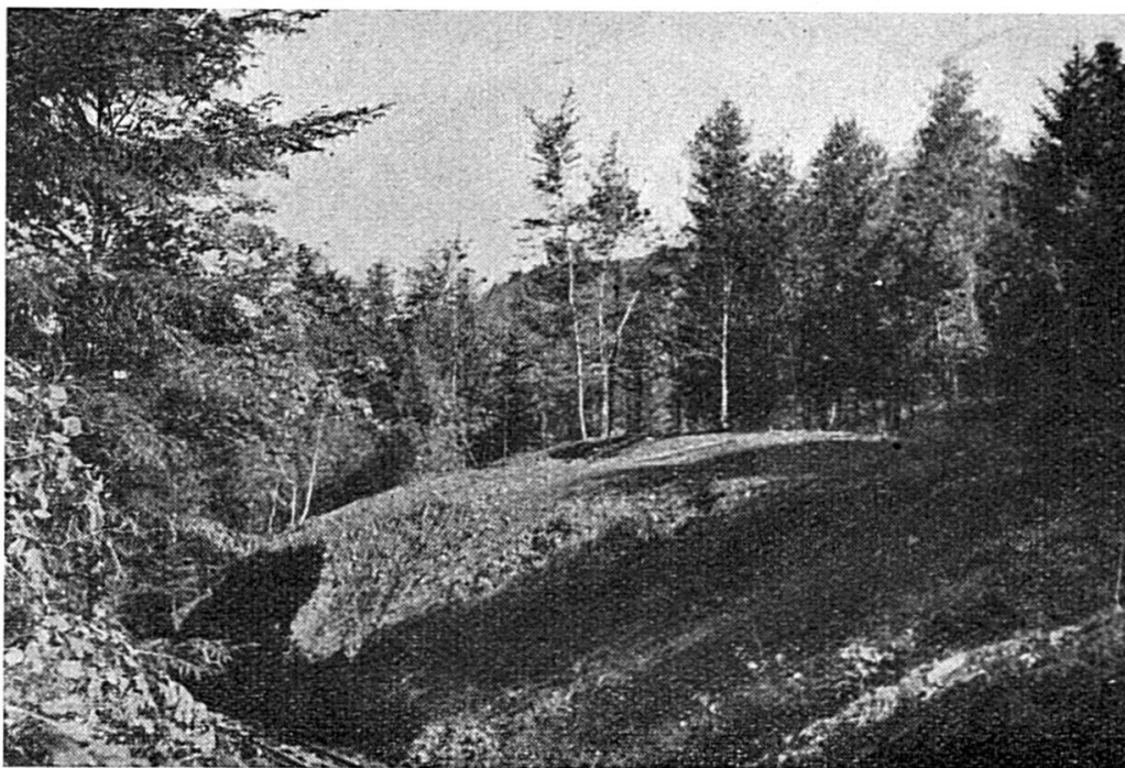
Les déblais du tunnel sont constitués surtout par de la marne. Ils ont fourni la masse de remplissage du puits.
