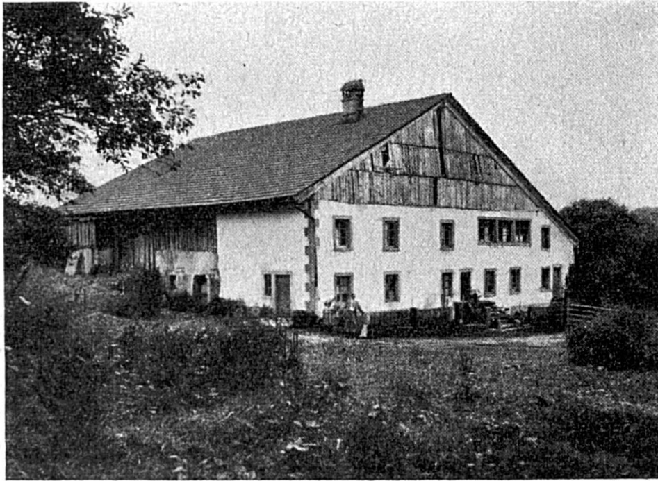
(Fig. 6.) Grande ferme abandonnée à Chauffour, commune de Soubey. N'est plus entretenue depuis des années.
