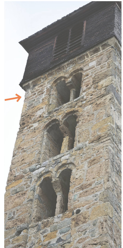
Abb. 4: Samedan, Kirchturm San Peter 2023. An der Fassade des obersten Geschosses und am Gesims zeichnet der mit Kalkschlämme weiss gefärbte Fugenputz eine Quadrierung nach (Pfeil). Darunter ist im Mörtel die Quadrierung durch Fugenstrich ausgezeichnet. Blick gegen Westen.
