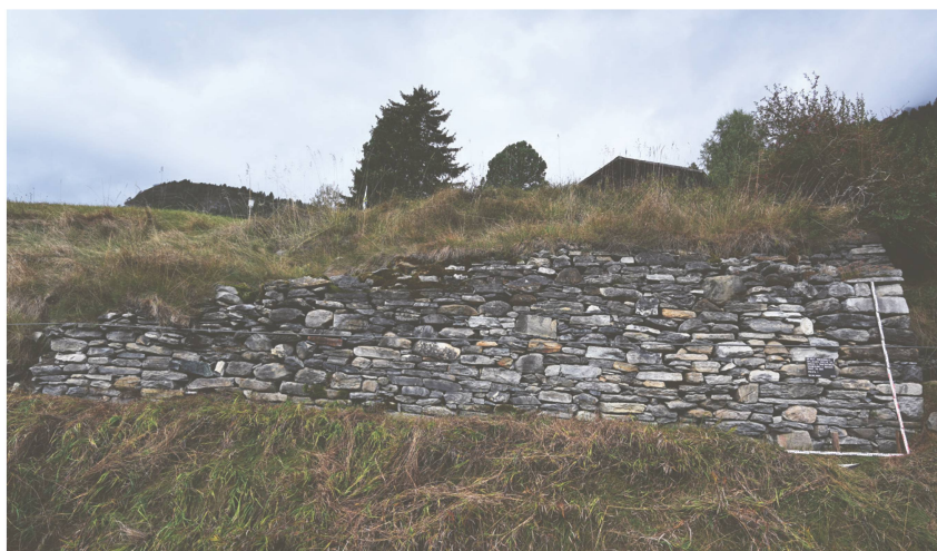
Abb. 1: Rheinwald, Splügen, Vorzustand. Kirchenruine St. Urban und Vincentius. Ostmauer.
