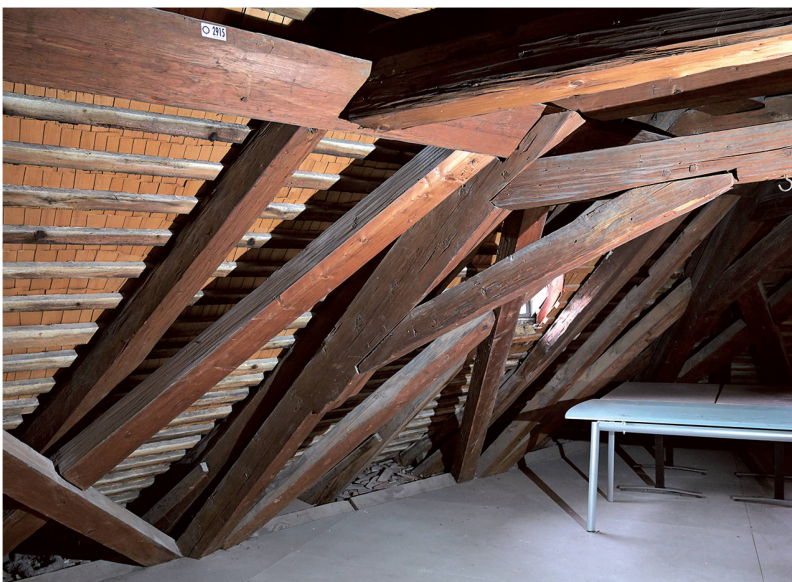
Abb. 9: Chur, Hof, Bischöfliches Schloss, Westtrakt. Liegender Dachstuhl von 1732. Die Kopfstrebe ist nicht mehr wie im 17. Jahrhundert an der Stuhlsäule und dem Spannriegel angeblattet, sondern durch eine Verzapfung mit Auflageversatz befestigt. Blick gegen Süden.
