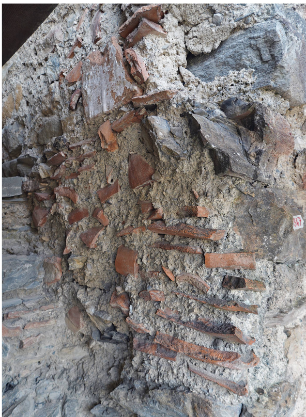
Abb. 2: Jenins, Neu-Aspermont. 2020. Grossflächige Reparatur aus Mörtel und darin verbauten Hohlziegelbruchstücken am Hauptturm. Blick gegen Südosten.
