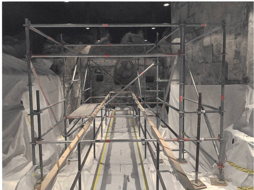
Abb. 3: Chur, St. Stephan. Abdeckung der historischen Mauern mit dampfdurchlässigem Vlies am 22. Mai 2019.
