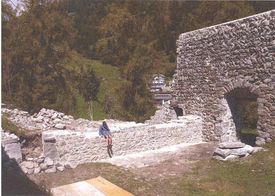
Abb. 2: Ilanz/Glion. Ruschein, Burganlage Frauenberg. 2014. Binnenmauer des Palas nach der Sicherung und dem Wiederaufbau. Blick gegen Norden.
