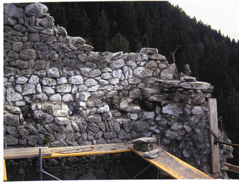
Abb. 143: Zillis-Reischen, Burgruine «Tur». Südost-ecke mit Torschwelle und Balkenauflegern des dritten Geschosses in gereinigtem Vorzustand.
