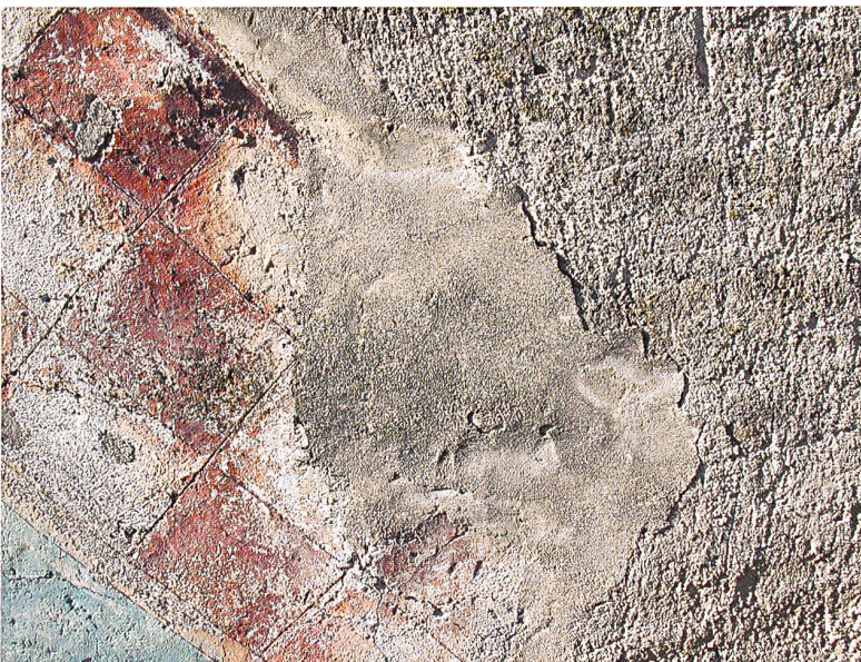
Abb. 78: Chur, Kathedrale St. Mariä Himmelfahrt, Altarhaus, Ostwand. Putzflicke von Restaurator Franz Xaver Sauter aus dem Jahre 1957 im Giebfries mit Befall von schwarzen Algen.
