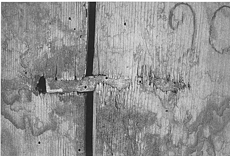
Abb. 121: Zillis-Reischen, Kirche St. Martin, Bilderdecke, Tafel 69. Rückseitig sichtbare, originale Verdübelung mit einem geschnitzten Holzdübel.
