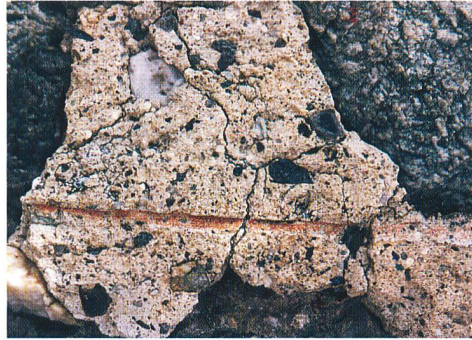
Abb. 129: Siat, Burg Friberg. "Pietra rasa"-Verputz mit ziegelrot eingefärbtem Fugenstrich.
