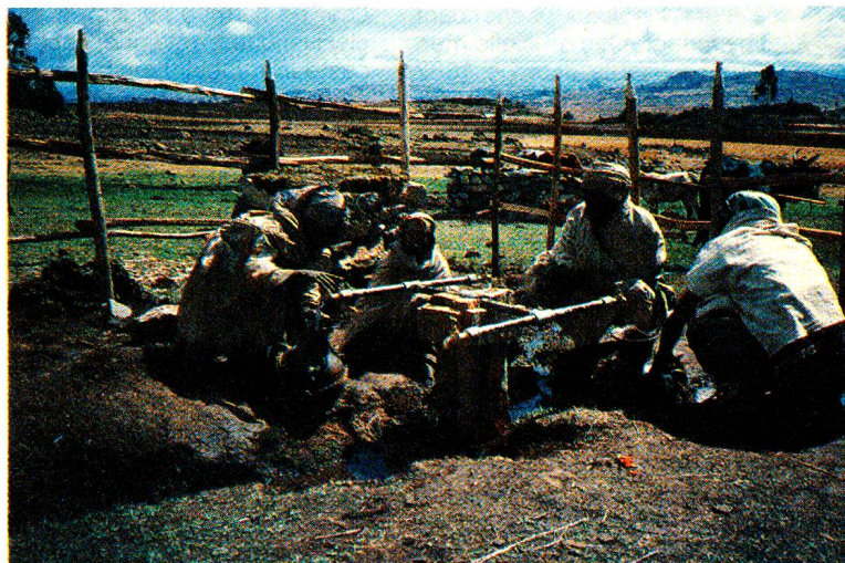
La protection des sources permet de garantir aux régions rurales un approvisionnement correct en eau potable, élément important en vue de l'amélioration à long terme de l'état sanitaire de la population.
