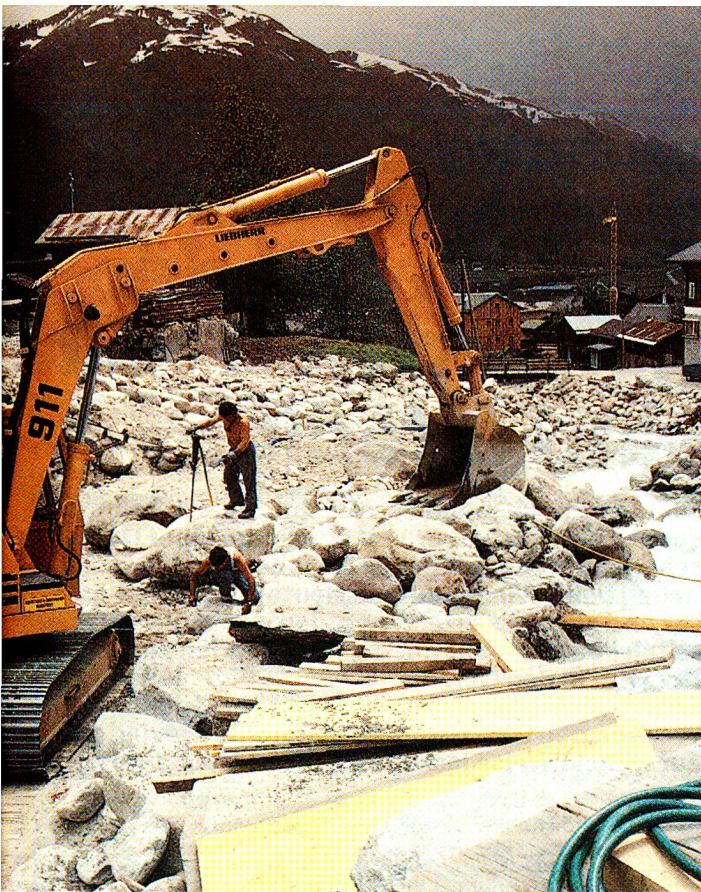
Noch müssen laufend Felsblöcke aus dem Bachbett geräumt werden.
