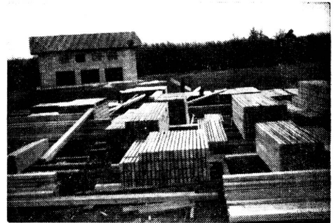
Das von der Schweizer Spende zur Verfügung gestellte Bauholz wird in St-Hilaire-du-Rosier (Isère) abgeladen und gelagert.
