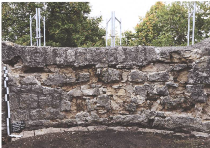
Schadensbilder, wie sie für die Farnsburg typisch sind: Die Innenwand des Blauen Turms nach Entfernung der frostzerstörten Mauersteine (ProSpect GmbH).
