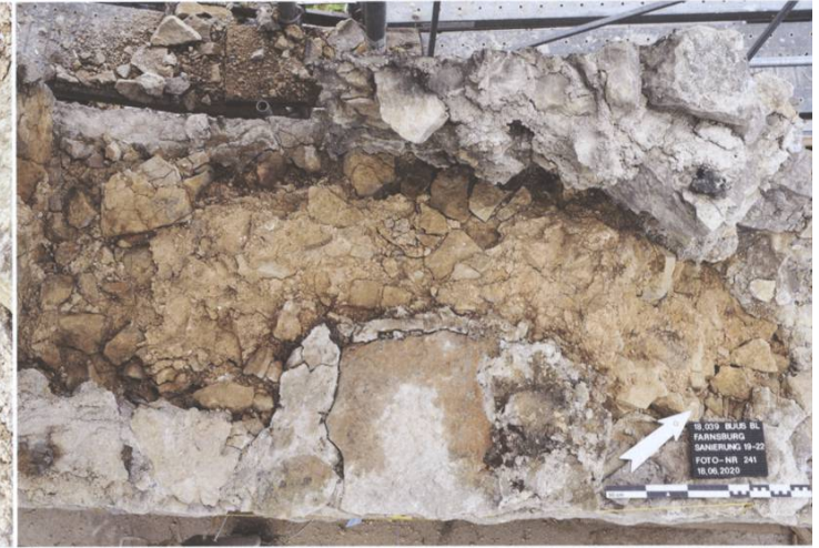
Gleiche Schäden, aber bereits vor Jahrzehnten saniert. Aufsicht auf die Ringmauer, aus der Burgenzeit ist nur der Kern aus gelbem Mörtel erhalten geblieben (ProSpect GmbH).
