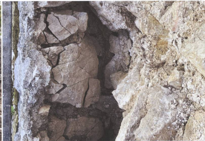
Ein vergleichbarer Schaden an der Ringmauer – nun in der Seitenansicht. Die Mauerschale ist durchgefroren und löst sich ab.
