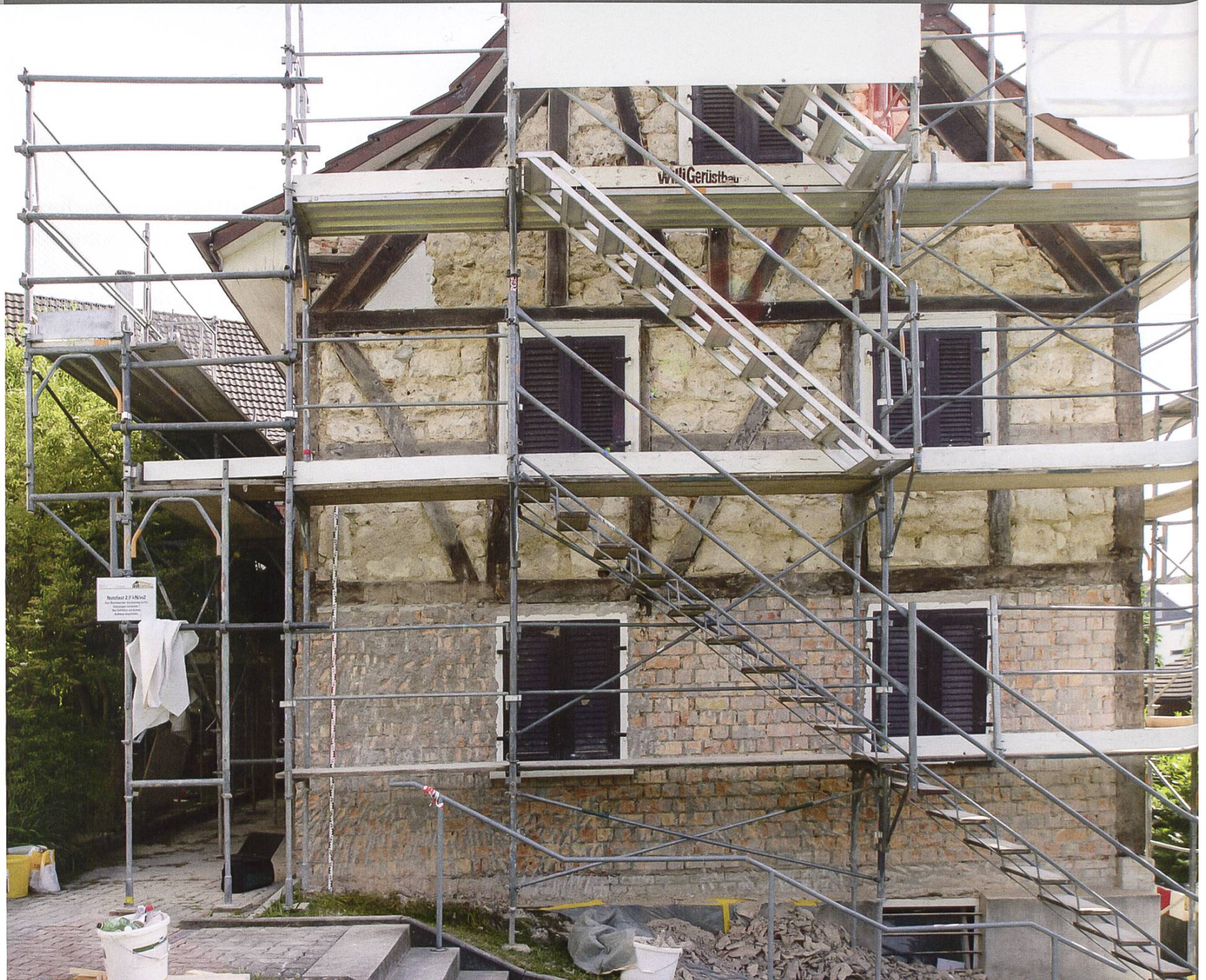
Schönenbuch, Kirchgasse 1a. Unter dem flächigen Verputz kam bei den Renovationsarbeiten eine Fachwerkkonstruktion zum Vorschein.
