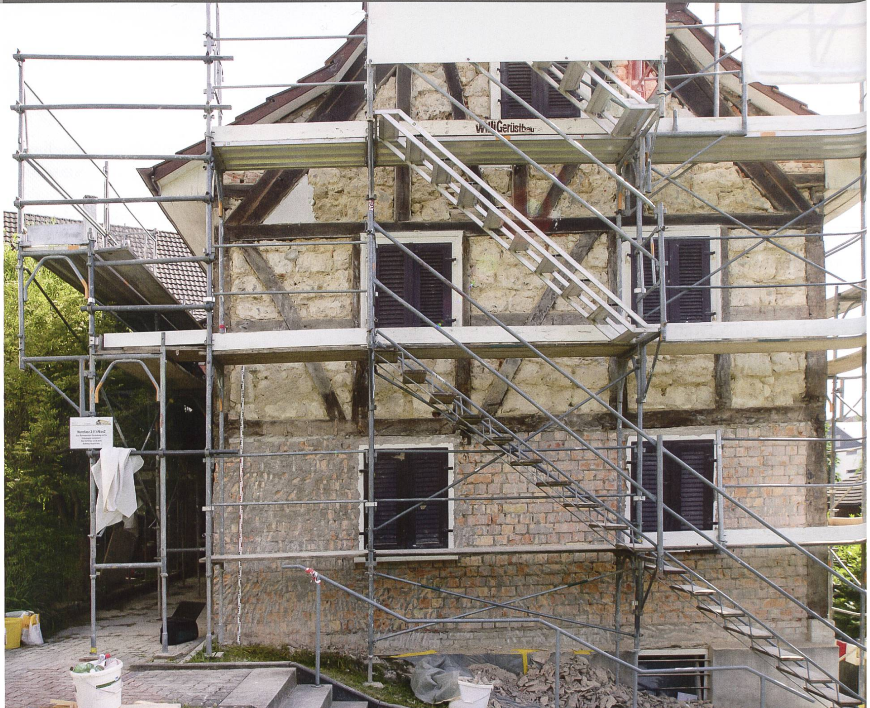
Schönenbuch, Kirchgasse 1a. Unter dem flächigen Verputz kam bei den Renovationsarbeiten eine Fachwerkkonstruktion zum Vorschein.
