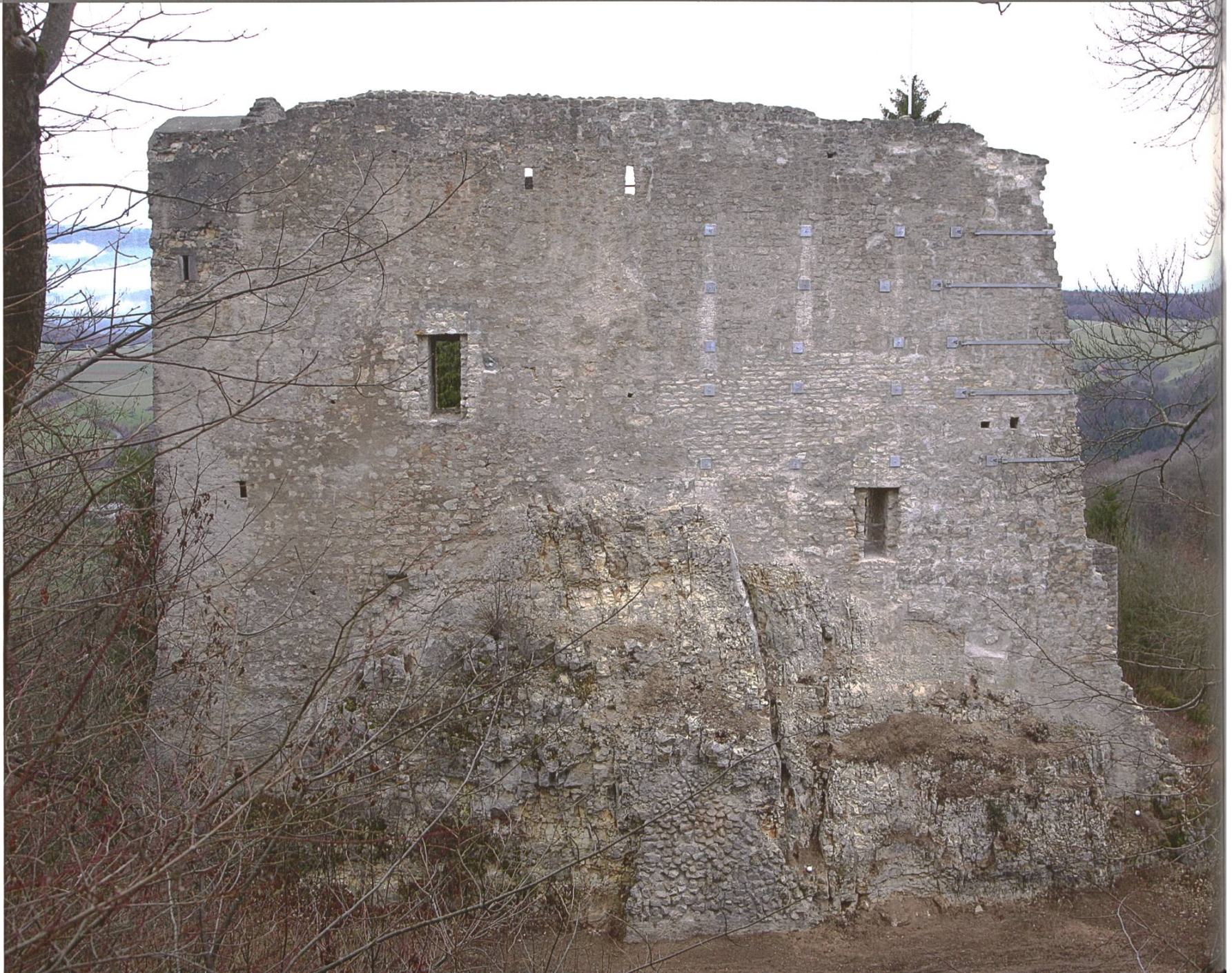
Farnsburg. Die Schildmauer von Süden. An der rechten Mauerhälfte angebrachte Anker und Spangen sichern neu das Mauerwerk.
