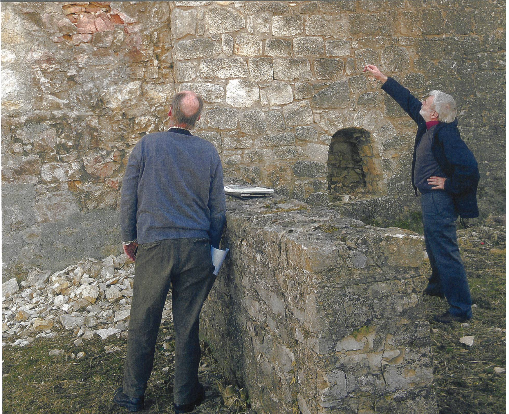
Farnsburg. Der Baumeister Richard Zuckwerdt und der Bauingenieur Joseph Müller begutachten die Schäden an der Innenseite der Schildmauer.
