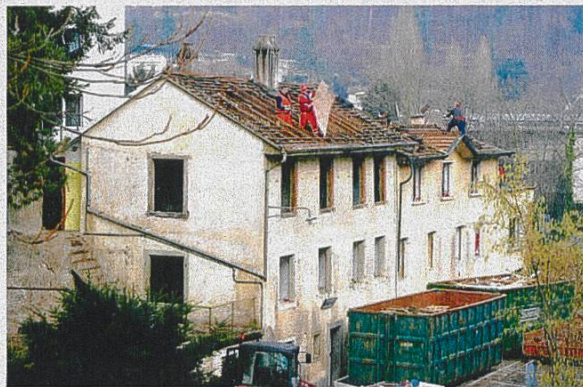
Akute Einsturzgefahr, Abbrucharbeiten an der Häuserzeile am Brunnwegli, festgehalten von der Archäologie BaselLand.
