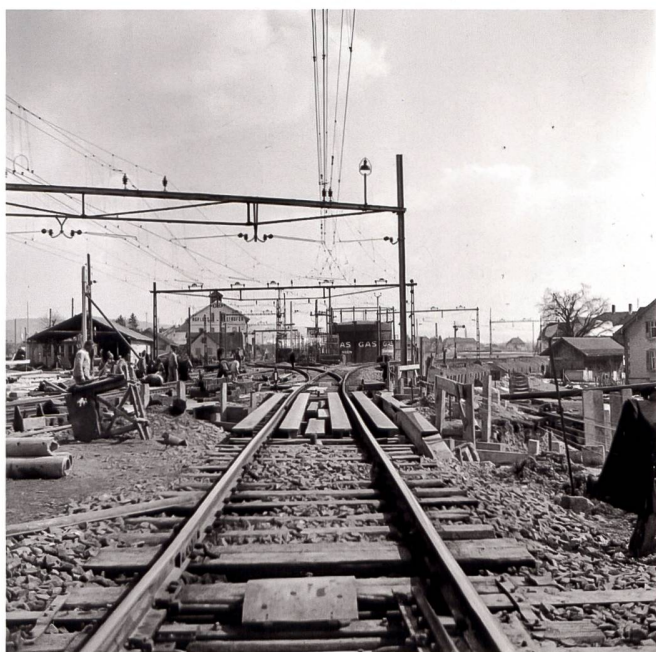
Zur Vereinfachung der Ausführung der Brückendecke wurden verschiedene provisorische Änderungen an der Gleisanlage notwendig. Foto Archiv SBB Historic
