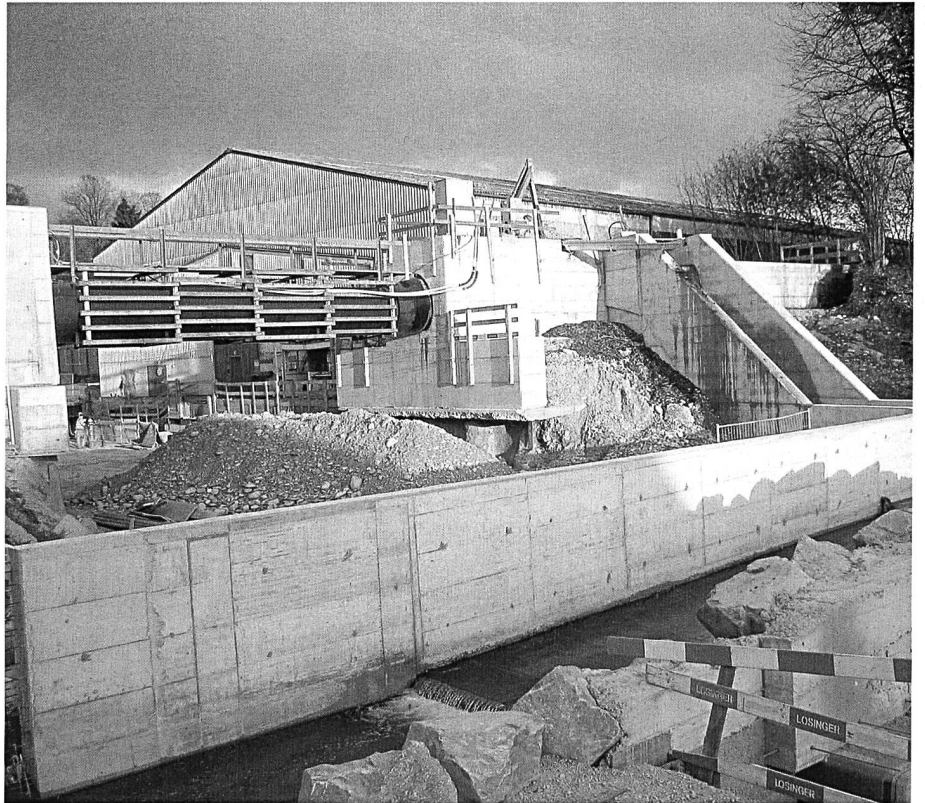
Die Überleitung des Tych und das Wasserschloss des Kleinkraftwerks Wäbi.
