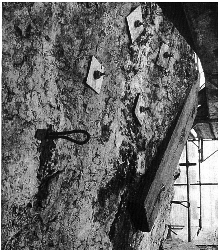
Vier bestehende Felsanker über dem Lifteingang, die ersetzt werden mussten.
