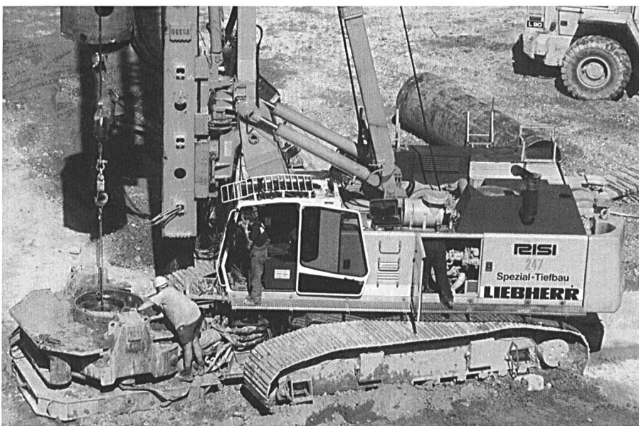
Stelzen für das Maschinenhaus. Rund 350 Pfähle mit je 120 Zentimetern Durchmesser wurden für das Fundament gebohrt.
