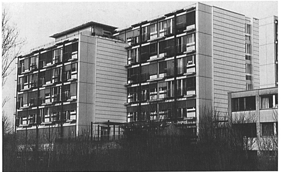
Die West- und ein Teil der Südfassade: Sie bewährt sich auch bei extremen Wetterverhältnissen — äussere Qualität im Alters- und Pflegeheim.
