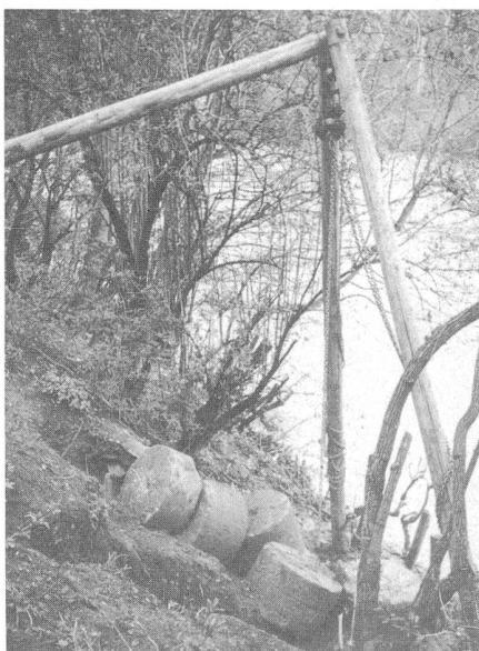
Aarebord beim Hause Hunziker, wo die Säulensteine zur Ufersicherung verwendet worden waren.
