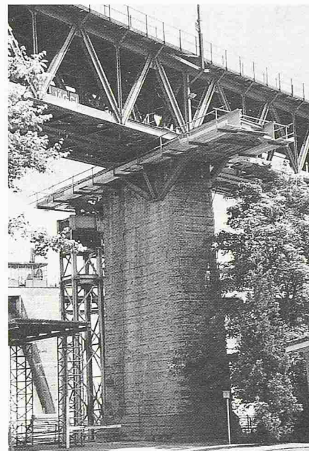
Bild 5. Der Pfeiler auf Seite Wettingen mit fertig installierter Doppelverschubbahn. Abstützung auf Pfeiler und Gerüsturm
