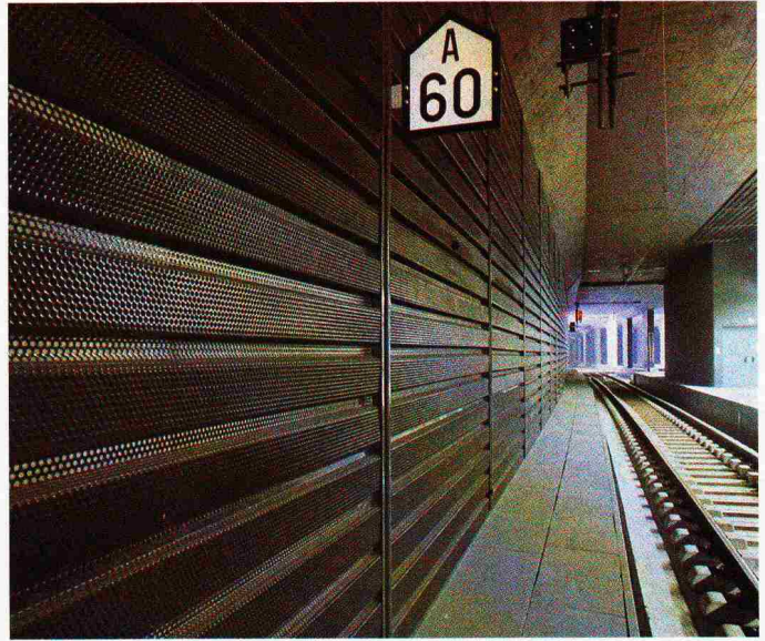
Bild 10. Schallschutzwand im Bereich des Gepäckkaulades
