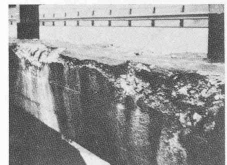
Bild 2. Tiefergehende Betonschäden an Kordonaussenseite. Armierungsseisen sind freigelegt
