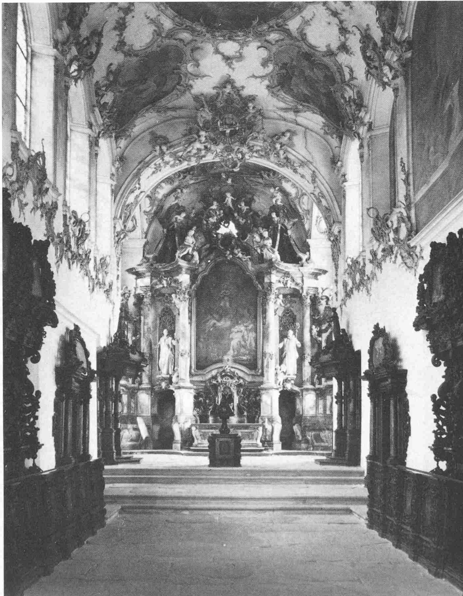
Bild 4. Chorbogen mit Schrägrissen
