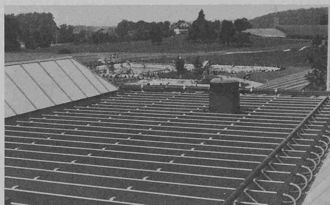
Auf dem Turnhallendach verlegte Niedertemperatur-Kunststoffkollektoren Sessa Exro erwärmen direkt das Schwimmbadwasser der Freibadanlage Bachmatten in Muri (AG)
