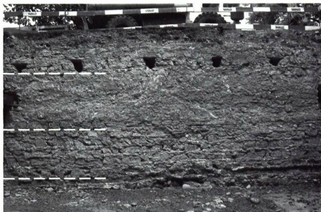
Abb. 28. Basel, Klingentalgraben 28. Ansicht der Rückseite der äusseren Grabenmauer nach dem Abtragen des Walls. Die gestrichelten Linien deuten die drei Bauetappen an. An der Basis der obersten Etappe ist eine Reihe von Gerüstbalkenlöchern zu erkennen. Foto ABBS.
