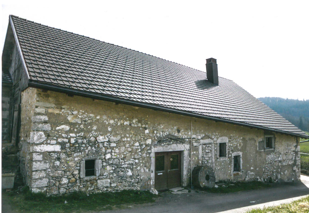
Fig. 6: Plateau de Diesse, Lamboing, Les Moulins 1. Façade ouest avant travaux. Diverses baies, parfois obturées, témoignent des modifications apportées au bâtiment au cours des générations.
