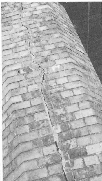
Links: Riss in einem Pfeiler einer Strassenbrücke
