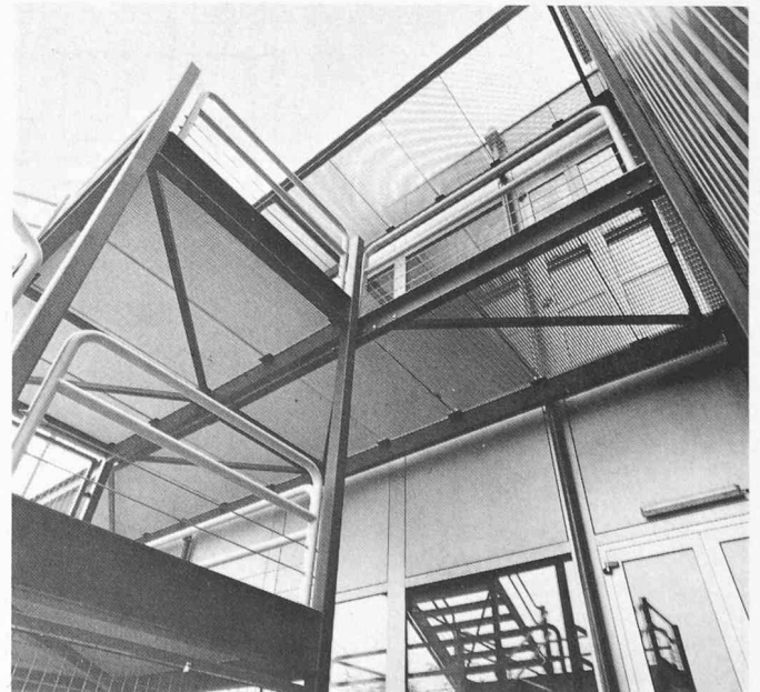
Bild 6. Laufstege als funktionelles und architektonisches Element
