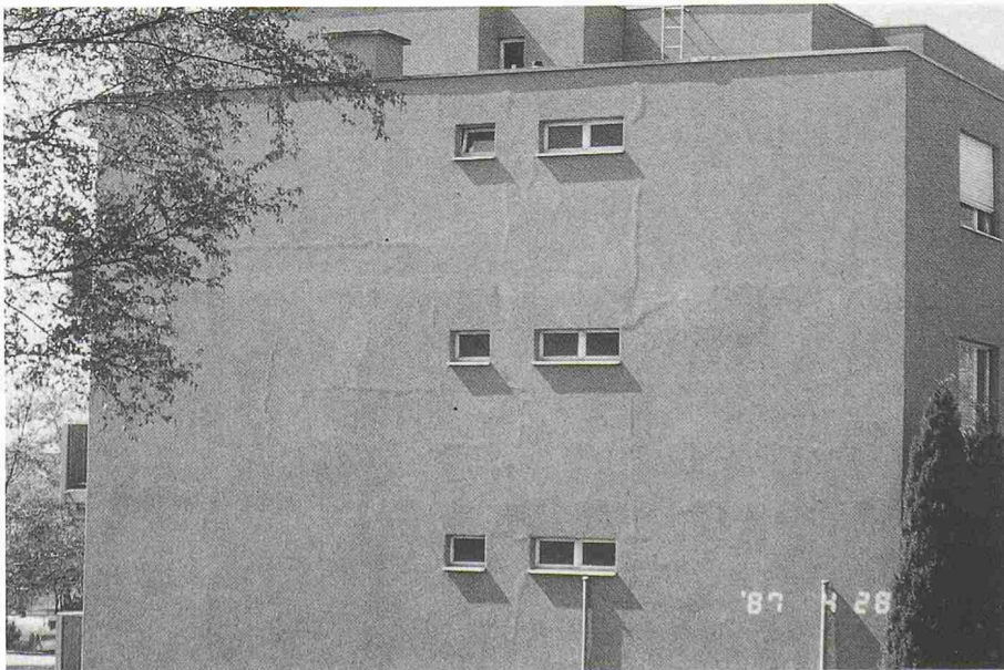
Bild 10. Starke Aufwölbungen im Deckputz, erst mehrere Jahre nach der Fertigstellung sichtbar. Als Ursache konnte eine zu hohe Feuchtigkeit des Mauerwerkes festgestellt werden
