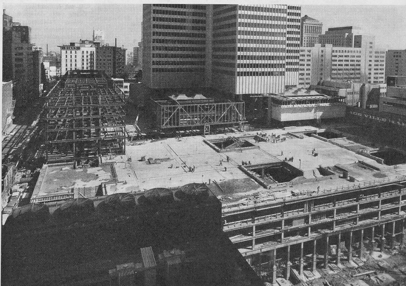
Fig. 14. Vue du projet en septembre 1961, montrant la construction des pavillons ouest à différents stades
