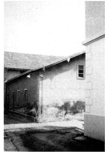
Der Südflügel des Gaswerk-Hauptgebäudes in originaler Länge mit drei Fensterachsen. Ausschnitt aus einer Fotografie von 1978 (StadtAC F 05.430.06).
