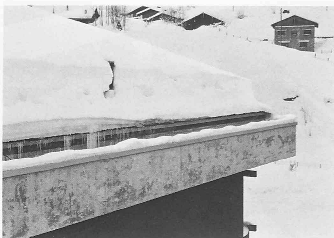
Bild 7. Traufbereich im Winter. Eisschicht sowohl über der Dacheindeckung wie auch zwischen Eindeckung und Unterdach
