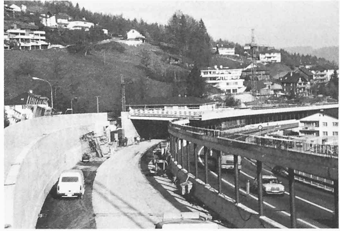
Bild 8. Nov. 1981: Versetzen der Betonrippenplatten auf Rückwand und Längsträger über der Mittelmauer. Verkehrsführung: Gegenverkehr auf der Seeseite
